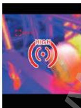
Alarm za visoku temperaturu
